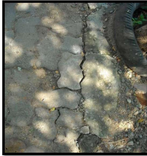
Gambar 2.6 Paving block tidak rata
