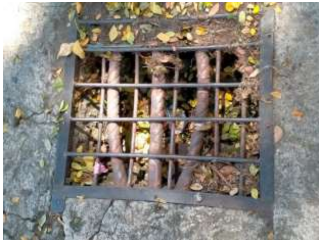
Gambar 1.2 Saluran masuk drainase yang sudah di penuh sampah dan pasir Sumber: Penulis (2023)
