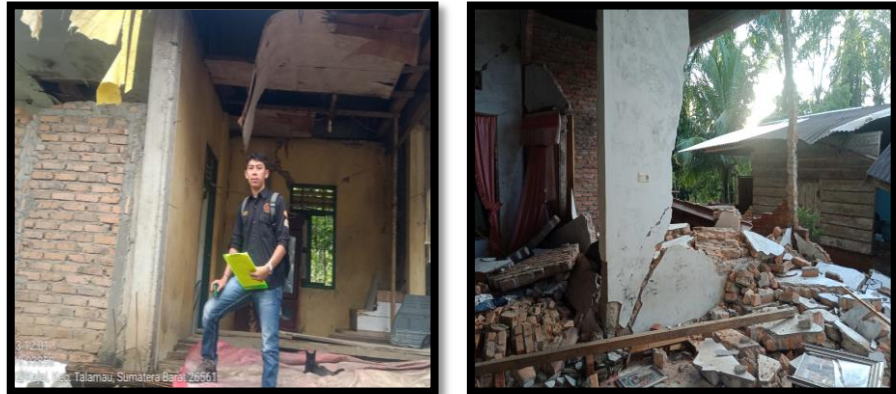
Gambar 1.3: Dampak Gempa Pasaman Barat Terhadap Bangunan Rumah Warga (Sumber: Kunjungan Lapangan, 2023 )
