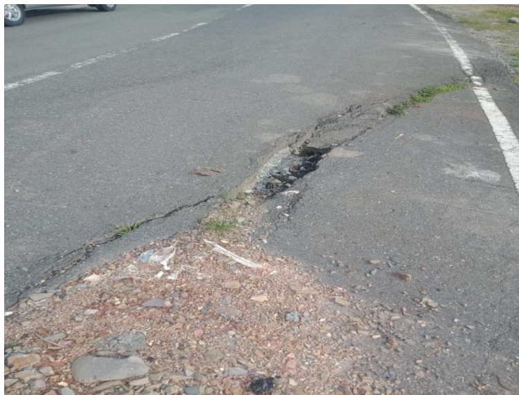
Gambar 1.1 : Kerusakan Jalan Sumber : Dokumentasi Pribadi
